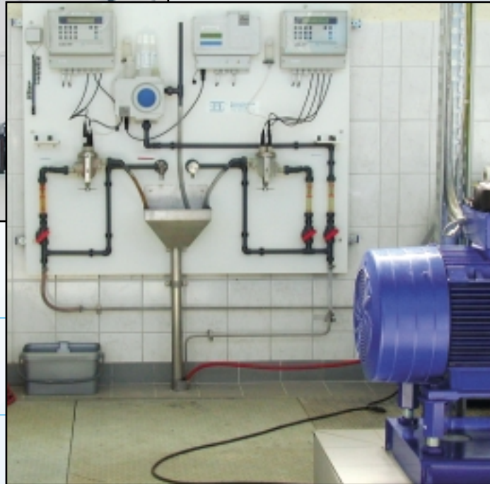
Güte-Messtafel im Wasserwerk Endlerkuppe / Sachsen Drinking Water Quality Panel in Waterworks Endlerkuppe / Saxony
